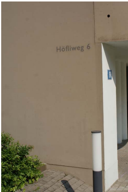
Risse im Sturzbereich
