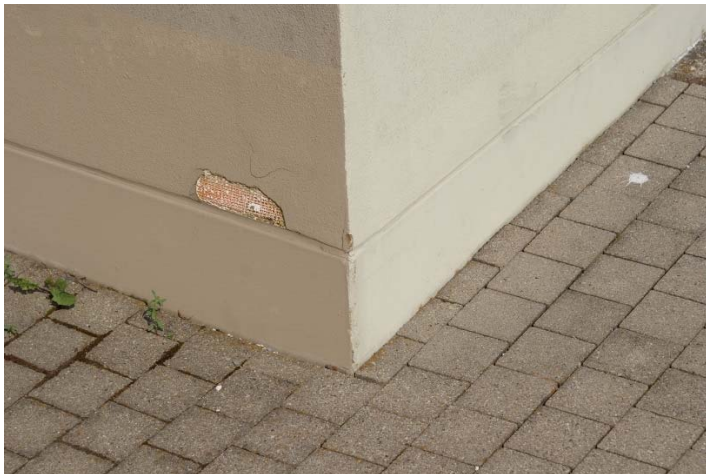
Verputzabplatzungen im Sockelbereich
