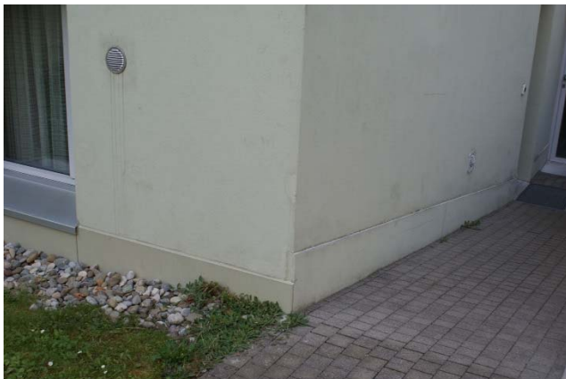
Verputzabplatzungen im Sockelbereich
