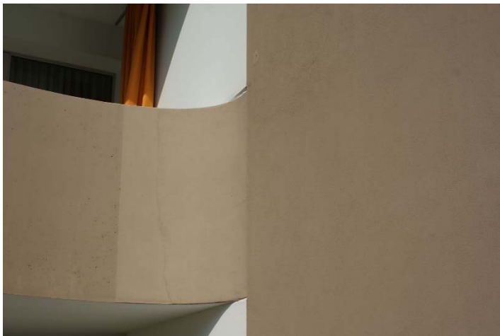
Farbkorrekturen bei den Balkonen
